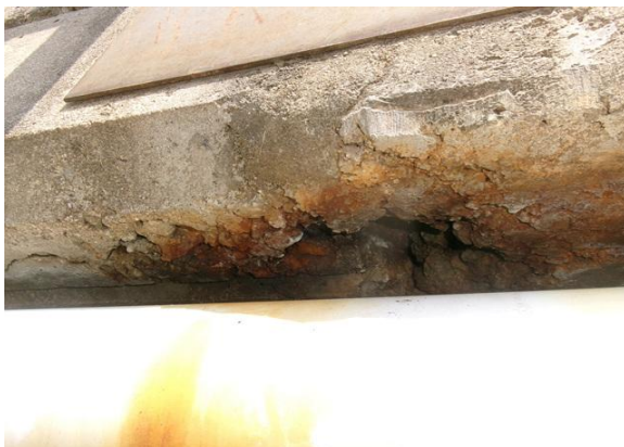
S4 바닥판하면 파손 및 철근노출
