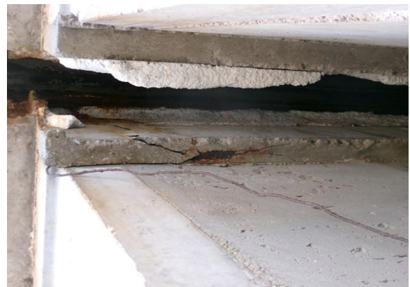
S6 바닥판하면 파손 및 철근노출
